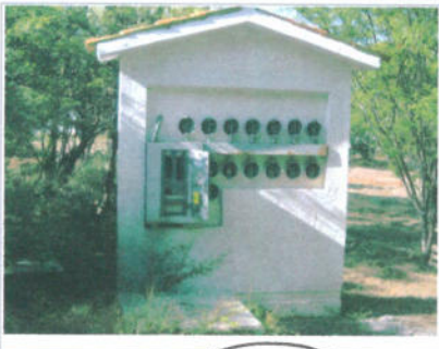
F3: Área para instalación de Wathorímetros
