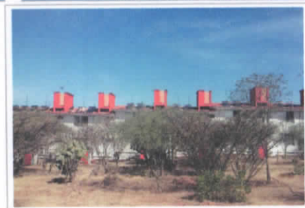
F4: Fachada posterior (instalación de calentadores solares)
