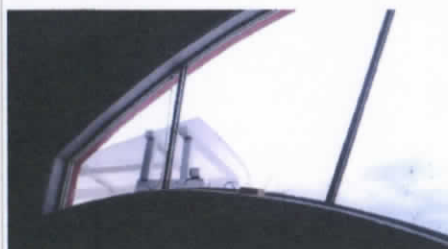
F2: Área Superior de Biblioteca. Torres instaladas
