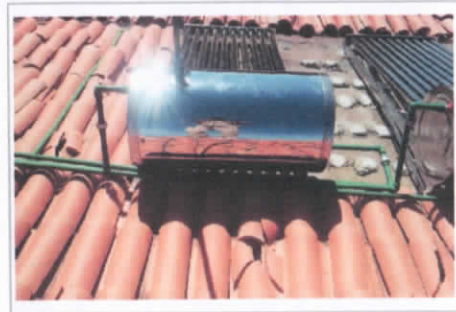
F2: Fachada posterior bajo pendiente (calentador instalado)
