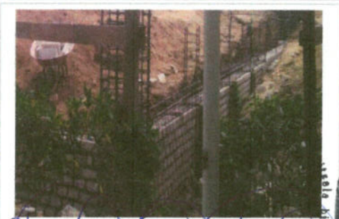
F5: habilitado y armado de acero de refuerzo en columnas y zapatas
