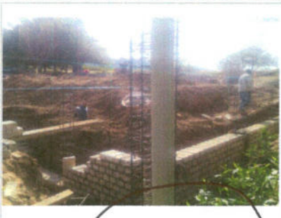
F3: Muro de cimentación, zapatas corridas y columnas, contratabres, cadenas y castillos
