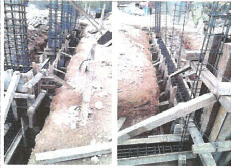
F1: Habilitado y cobrado de acero de refuerzo y cimbrado de cimentación.
