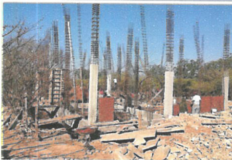
F2: Colado de columnas en P.Baja y muros de tabique de 14 cm.
