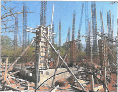
F3: acero de refuerzo en estructuras y cimbrado de columnas en P. baja
