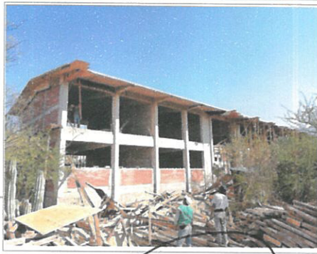
F3: Descibrado de traveses y volado de losa de azotea, muro de tabique de 14 cm.
