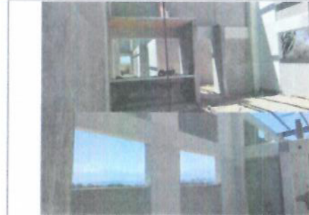
F5. Aplazado del concreto armado (vigas, en contrabeams y contrasientos)
