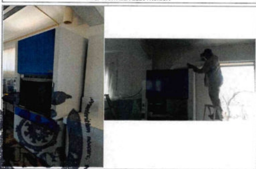
F4: CAMPANAS DE EXTRACCION
