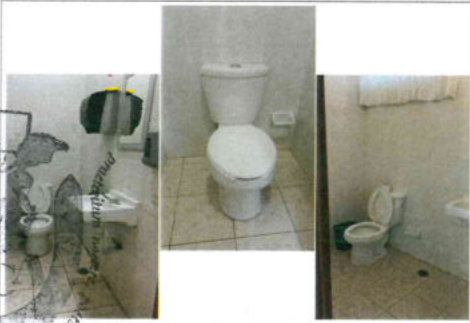
INSTALACIÓN DE AHORRADORES EN EDIFICIO ADMINISTRATIVO
